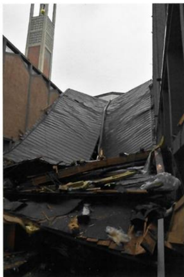
Elisabethkirche Kassel - nach dem Dacheinsturz November 2023
